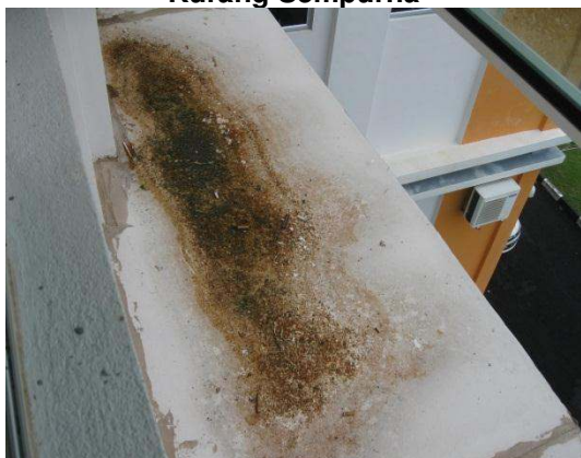
Gambar 2.2 Pemasangan Copping Yang Kurang Sempurna
