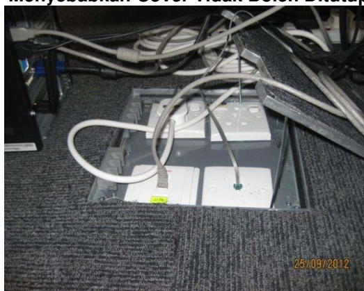
Gambar 2.3 Kedalaman Trunking Tidak Mencukupi Menyebabkan Cover Tidak Boleh Ditutup
