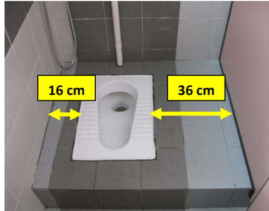
Gambar 2.8 Jarak Mangkuk Tandas Yang Tidak Sama
